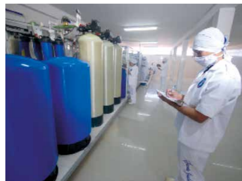
Equipo de tratamiento de agua.
